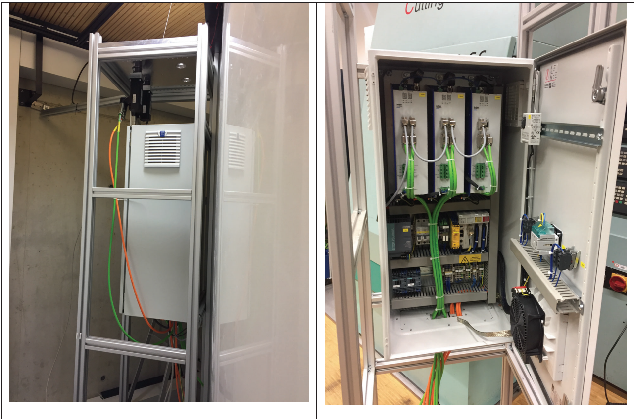
Abbildung 4.2-10: Schaltschrank hinter der Leinwand
