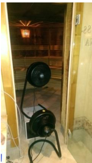
Bild 6: Leistungsstarke Spezialventilatoren zur Lüftung der Saunaräume (unten Zuluft in den Saunaraum, oben Abluft aus dem Saunaraum)
