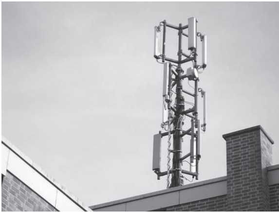
Abbildung 18: Sendefunkanlagen für den Mobilfunk
