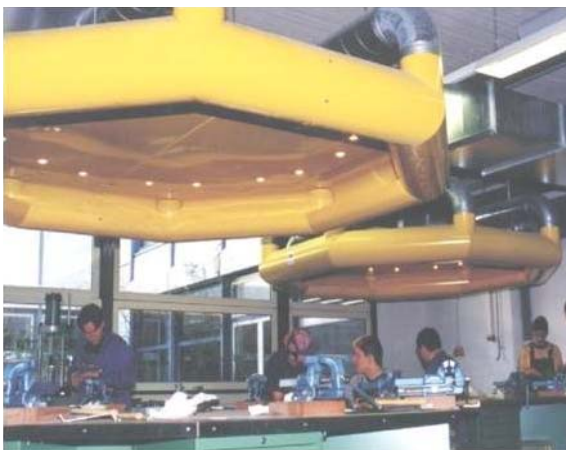
Abbildung 6: Erfassungshaube mit Randabsaugung
