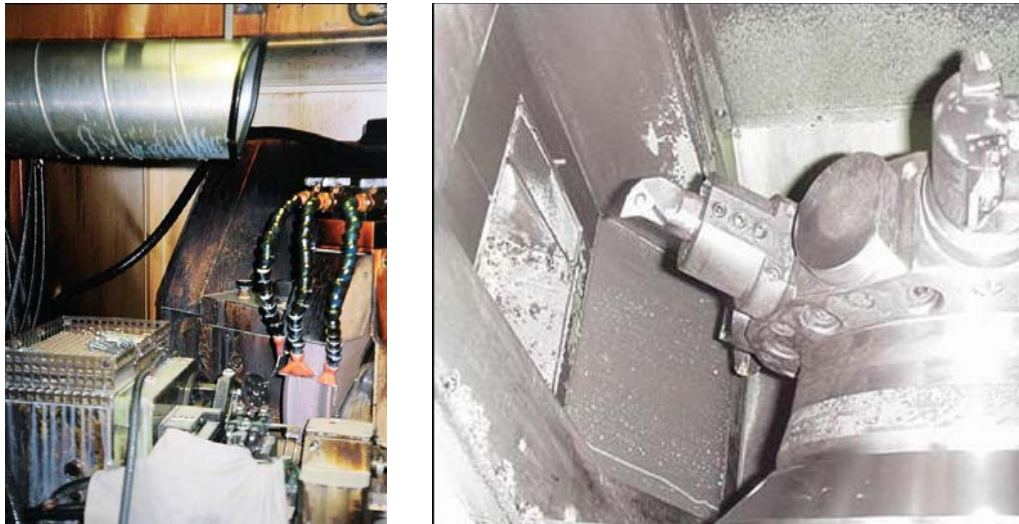
Abbildung 2: Beispiele für Erfassungseinrichtungen, die zu dicht an der Bearbeitungsstelle angeordnet sind
