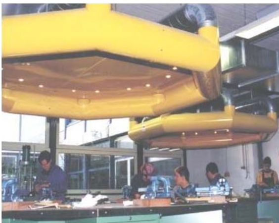
Abbildung 6: Erfassungshaube mit Randabsaugung
