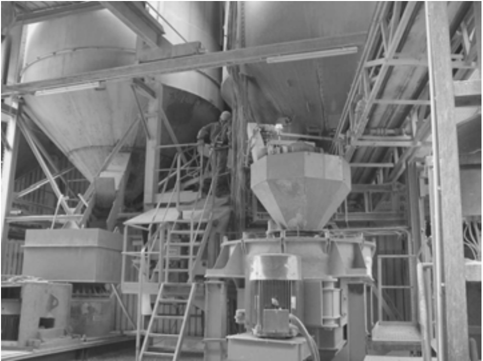
Abbildung 23: Brecheranlage im Kieswerk
