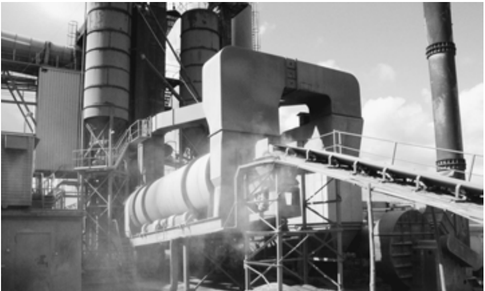
Abbildung 28: Trockentrommel einer Asphaltmischanlage
