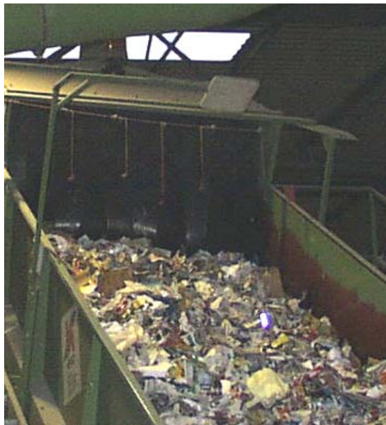
Förderanlage mit nachgeordneter Kanalballenpresse Gefahrstelle: offene Einfüllöffnung
