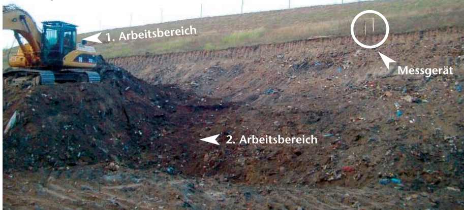
Abb. 1: Falscher Ort zur Platzierung des Messgerätes (s. im Vergleich Abb. 3)
