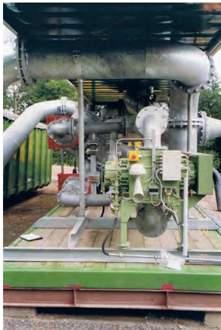
Abb. 4: Gebläsestation mit Regeleinrichtungen und Deflagrationssicherungen (rot) auf der Saug- und Druckseite
