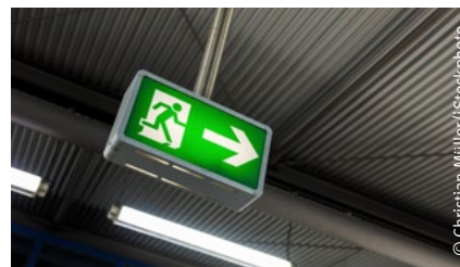
Abb. 2 Visuell kontrastreich gestaltete Information: Fluchtwegbeschilderung
