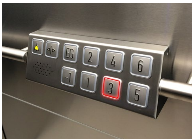
Abb. 8 Anordnung von Handlauf und Bedienelementen in Aufzugskabine
